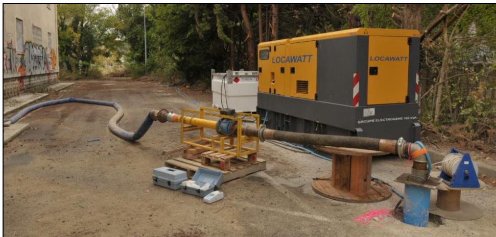
Photographie 3 : dispositif de pompage
